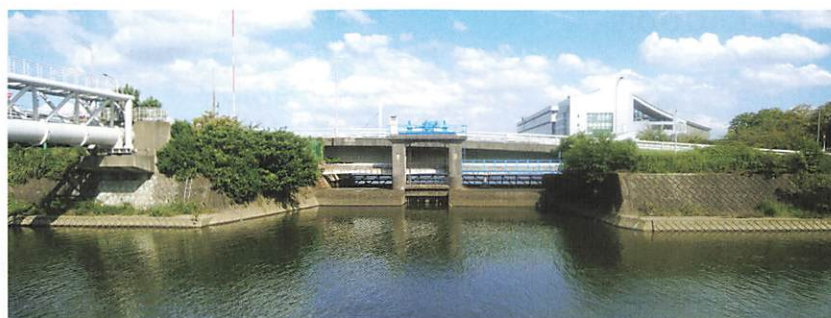
中央が取水口水門、両サイドが越流堤。水面を右に行くと荒川（笹目水門、ポンプ場）。写真右奥の建物は戸田競艇場。
